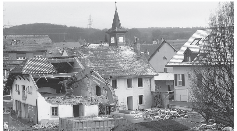
Le 4 février, il lui manque déjà un bout de toit!
